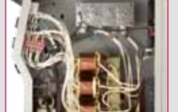
Hochleistungstrafo mit 20 Schaltstufen
